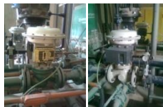
Gambar 4.3 Katup air dan katup udara
